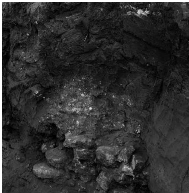
Обрушившаяся кладка стен подземного коридора, ведущего из алтарной части церкви 1802 г. к югу, под фундамент. (Фото А.А. Паламаря-старшего).
